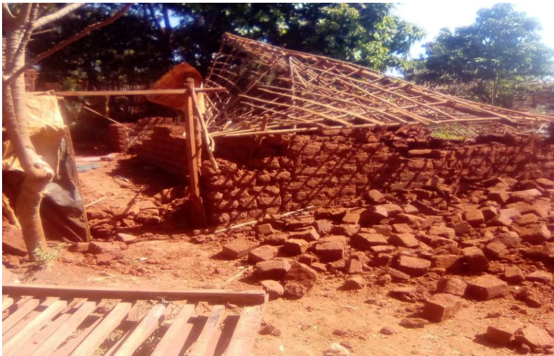
Des maisons démolies dans le camp de réfugiés de Nduta
